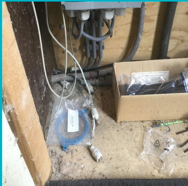
Niet alles was aangesloten en problemen met elektra.
